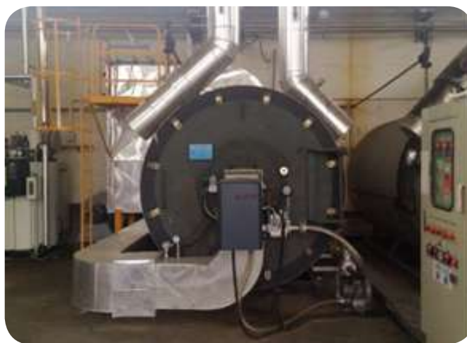
岱稜天然氣鍋爐正視圖
