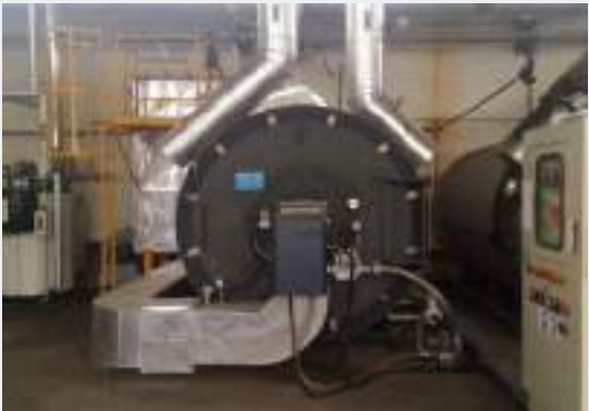
岱稜天然氣鍋爐正視圖
